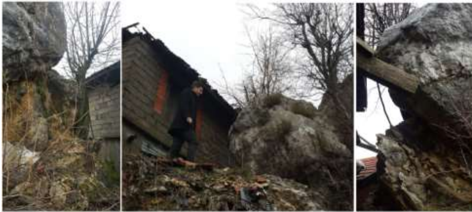
Resim 2.1 Burdur İli Ağlasun İlçesi Çamlıdere Köyü Kaya Düşmesi Etüdü.
